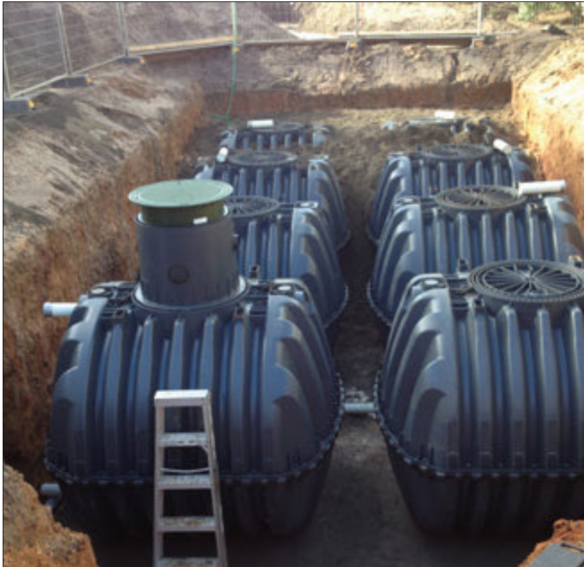
52.000 l, nave industrial, Perth (Australia)
